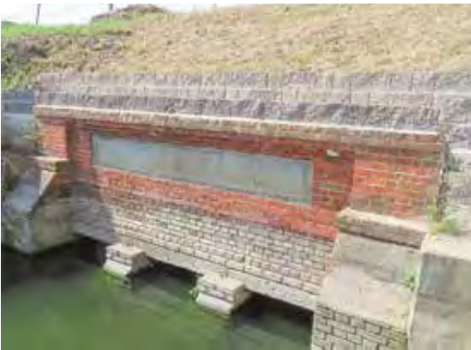
図2 宮井第二閘門（和歌山市布施屋） 明治41（1908）年竣工。扁額は記念碑になっています。
